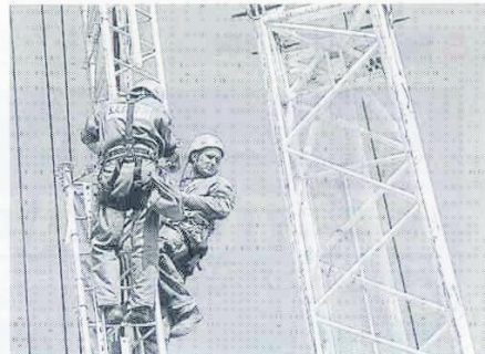
Dix employés ont dressé hier matin le pylône, la pose a nécessité le déploiement d'une grue, acheminée depuis l'Alsace. Photo N. Bourreau
